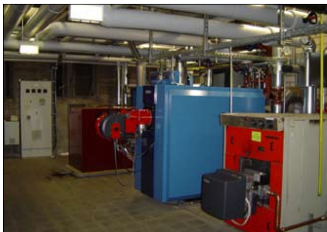
Neue Energieerzeugung (von hinten) -Blockheizkraftwerk -Brennwertkessel, -Reservekessel
