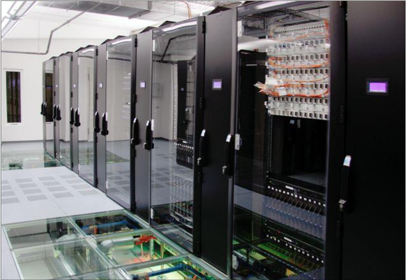
Direktgekühlte Serverracks mit Kälteversorgung im Doppelboden
