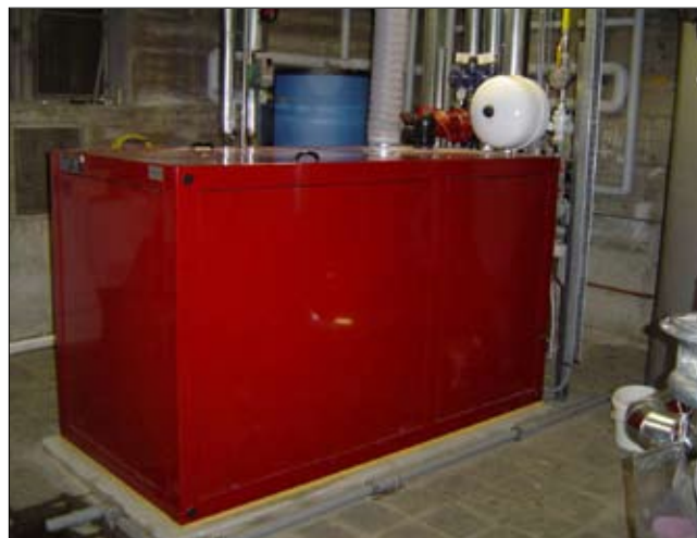
Neues Blockheizkraftwerk (BHKW)
