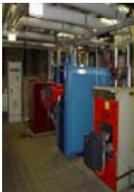
Energieerzeugung in der LVR-Frida-Kahlo-Schule, Förderschwerpunkt körperliche und motorische Entwicklung in St. Augustin
