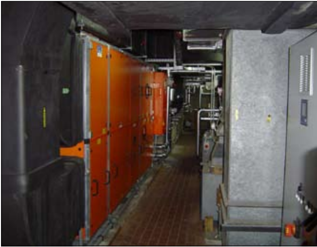
Neue Lüftungsanlage (links)
