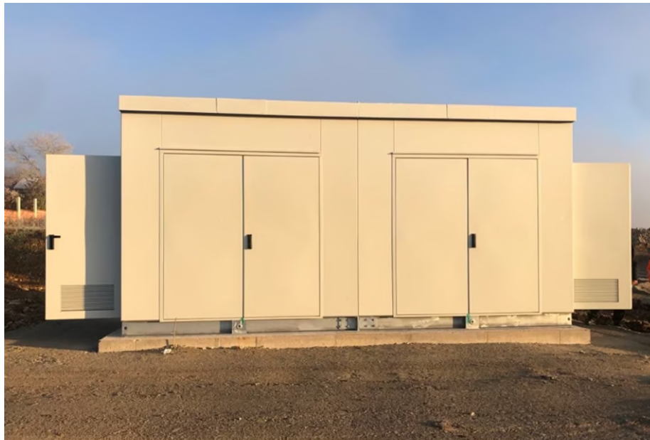
Abbildung 2 - Beispiel einer Druckerhöhungsanlage in Außenaufstellung
