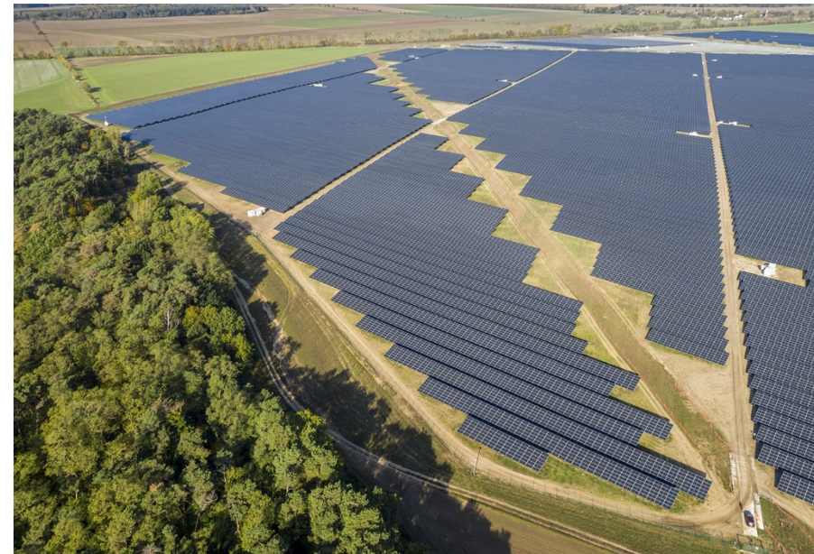
EnBW 187 MW-Solarpark Werneuchen (Brandenburg),
