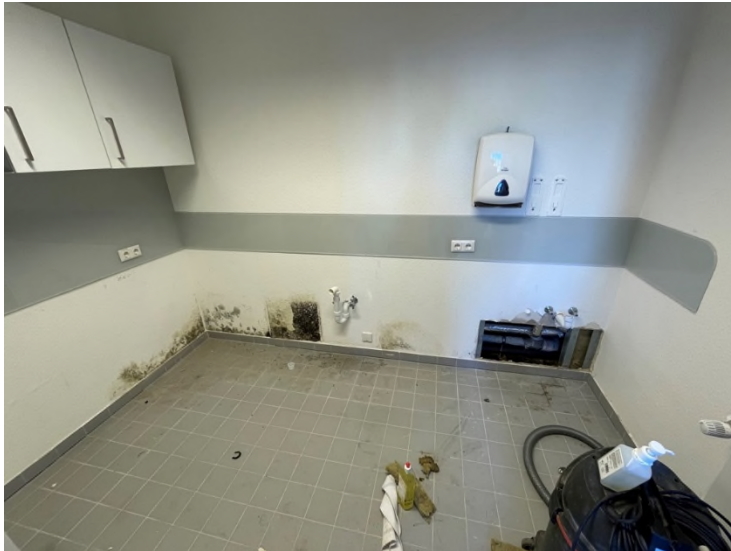
Foto: Rohrbruch vom 02.03.2021; Bereich hinter einer Küchenzeile (Bildnachweis: LVR-Klinik Mönchengladbach)
